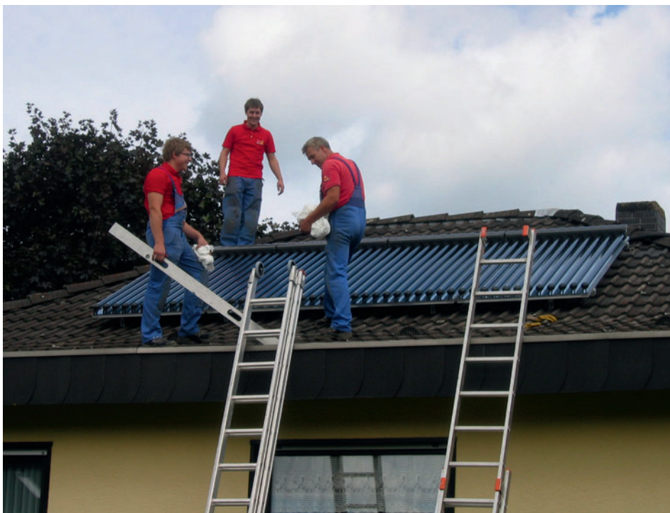
Das Team von Haustechnik Berners bei der Montage der Solarkollektoren. Foto: M. Berners
